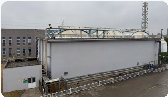
废水生化AO处理池
