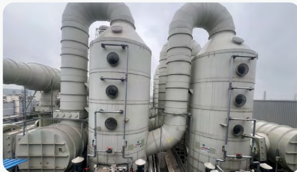
废气处理装置——酸雾塔
