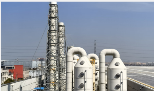
废气治理设施
