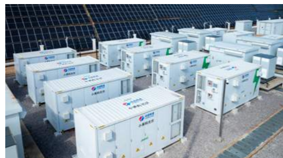
向云南小黑蚂蚁光伏 + 储能项目交付 42MWh 储能系统
