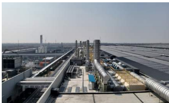
废气治理设施
