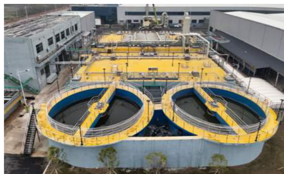
废水治理设施
